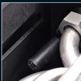
Wasser-Füllstandanzeiger zur Kontrolle des Wasserstands im Heizkessel
